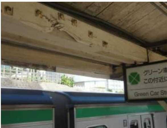
J R 根府川駅のホームの天井梁にある銃撃跡 ちょうど上り電車がすべりこんて来た。
